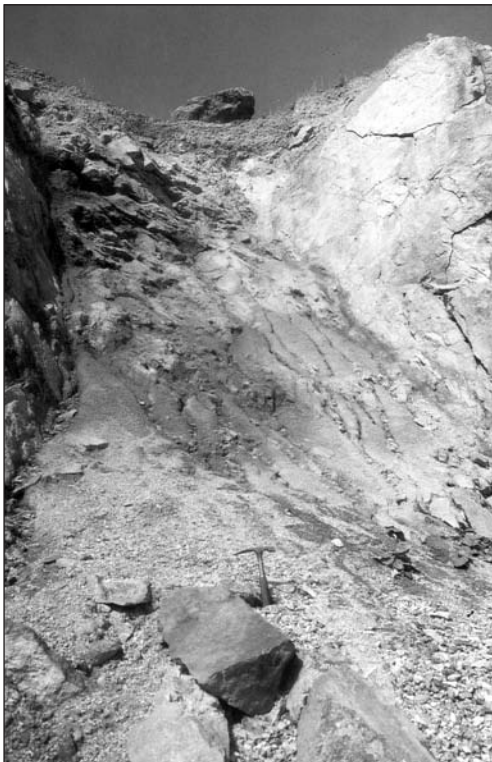
Abb. 20 Stark verwitterter Bereich; 2. Sohle, W
