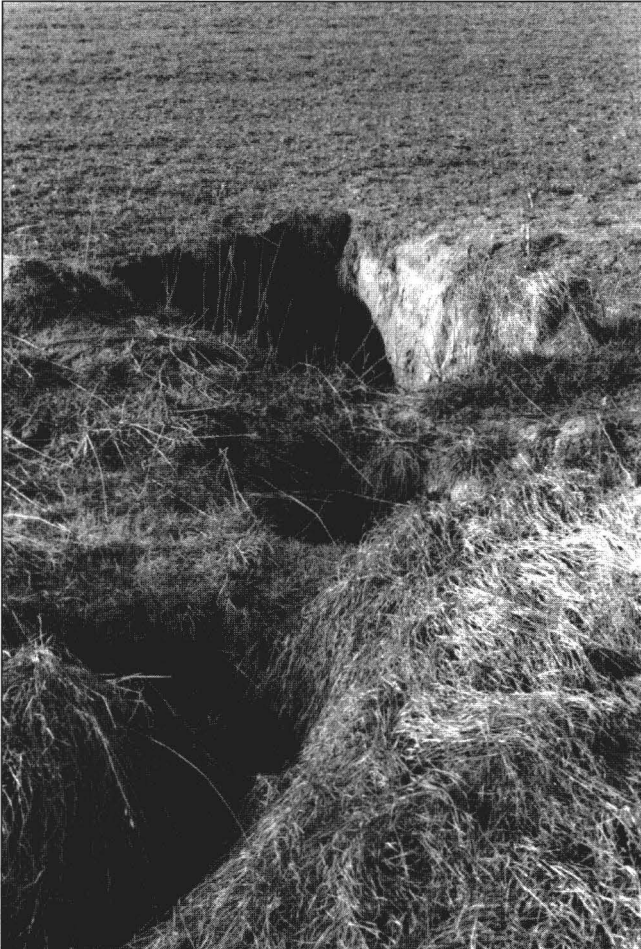
Abb. 4 Eingestürzte Tunneldecke im Löß
