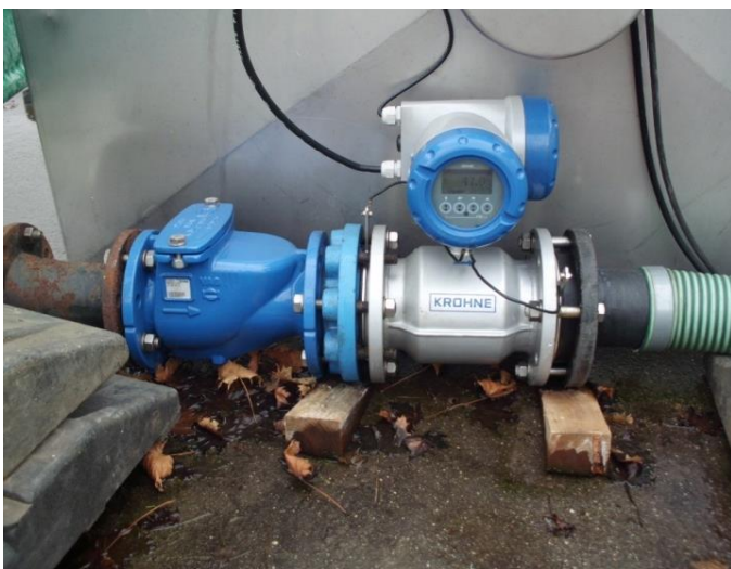
Abbildung 10: Zulauf mit MID und Rückschlagklappe
