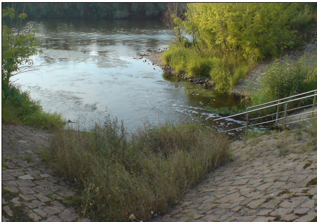
Abb. 36: Ablauf der Kläranlage Halle-Nord (Stelle 3) mit dem befestigten Ablaufkanal zur Saale
