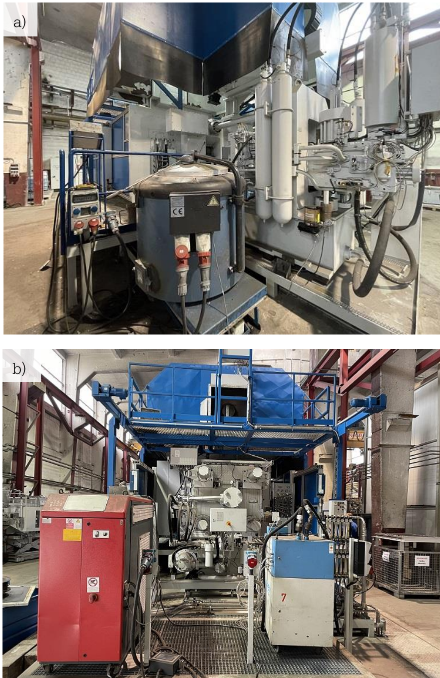
Abbildung 7-3: Druckgießanlage: a) Vakuumentlüftung und Hydraulik zur Bewegung des Gießstempels, b) Kühlkreislauf der Formhälften und Hydraulik der beweglichen Formhälfte
