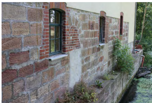
2019. Mühlenhof. Blick auf dem Turbinenraum. (HWZ #A.070)
