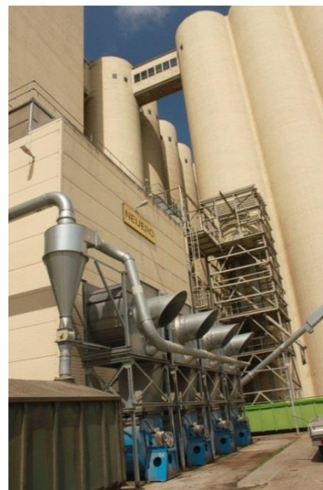
b) Siloanlage mit vier Dächerschachttrocknern (Hage Nord, Standort: Neubrandenburg)
