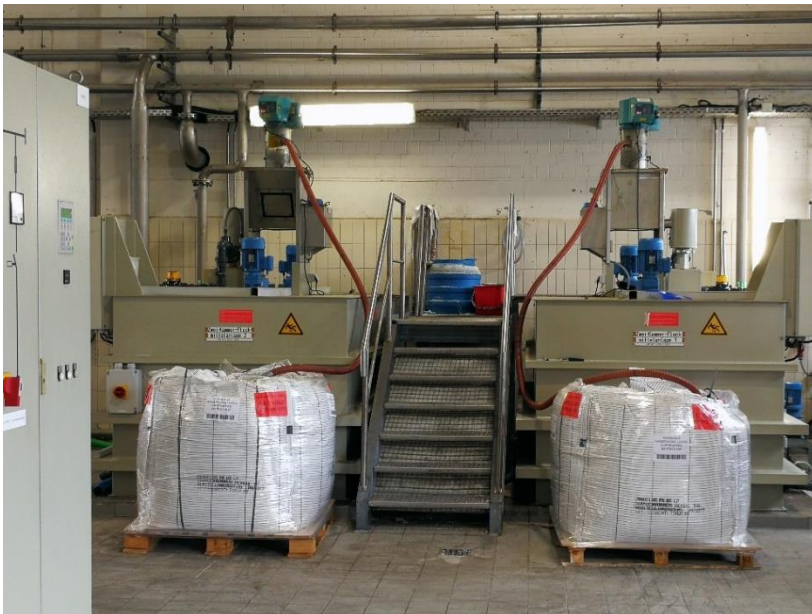
Abbildung 19: FHM-Anlage 2 (links) & FHM-Anlage 1 (rechts) mit jeweils zwei Kammern
