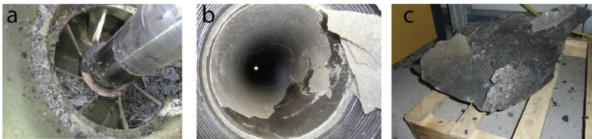
Abbildung 21: Ausfällungen in Anlagenteilen der Geothermieranlage Kirchstockach, a: Pumpenrad, b: Pumpengehäuse, c: Anlagenteile an der Oberfläche, (Wanner, Eichinger, Jahrfeld, Diamond 2017)
