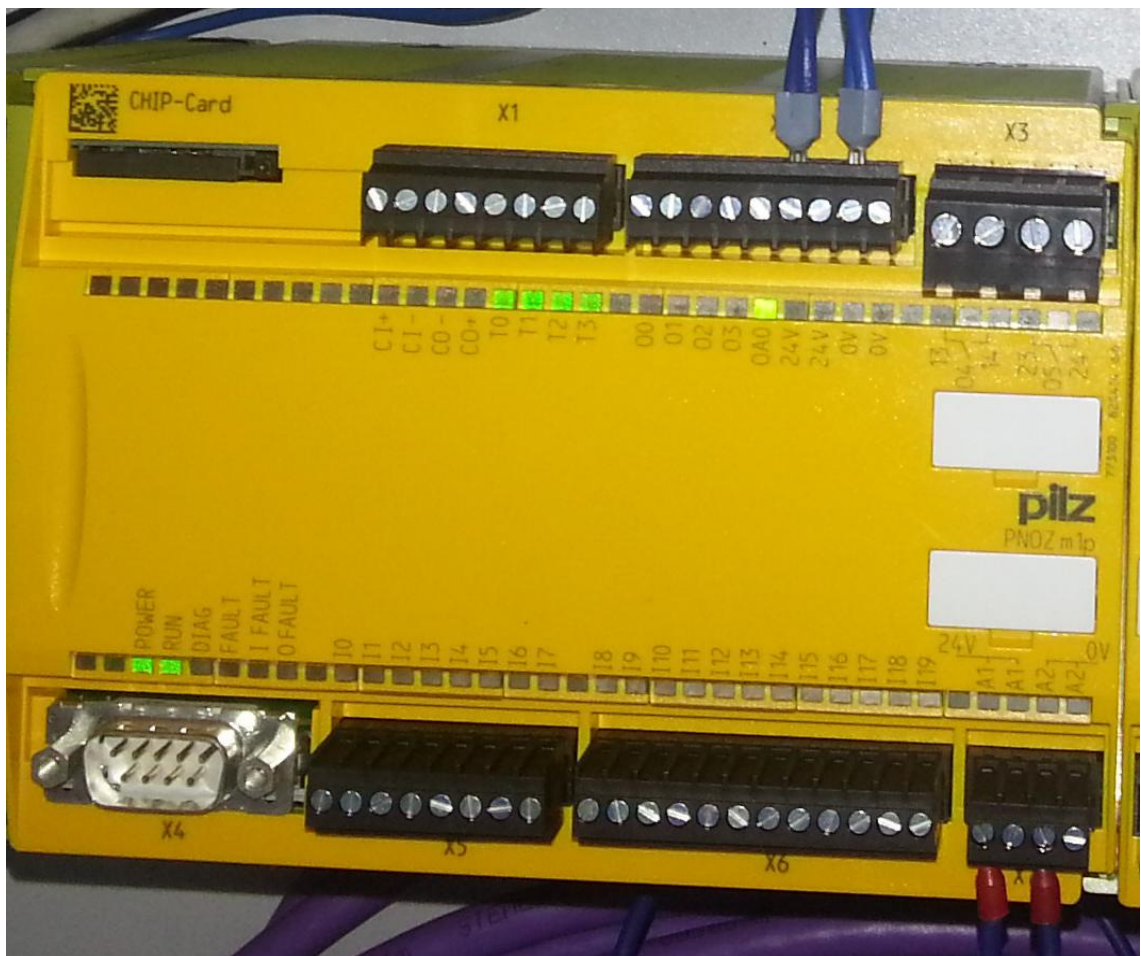
Abbildung 4-26 PILZ PNOZmulti mit Stromanschluss
