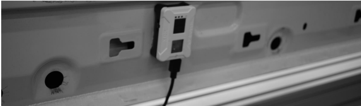
Abbildung 48: XDK Sensor zur Erfassung der Lichtstärke und Raumtemperatur.
