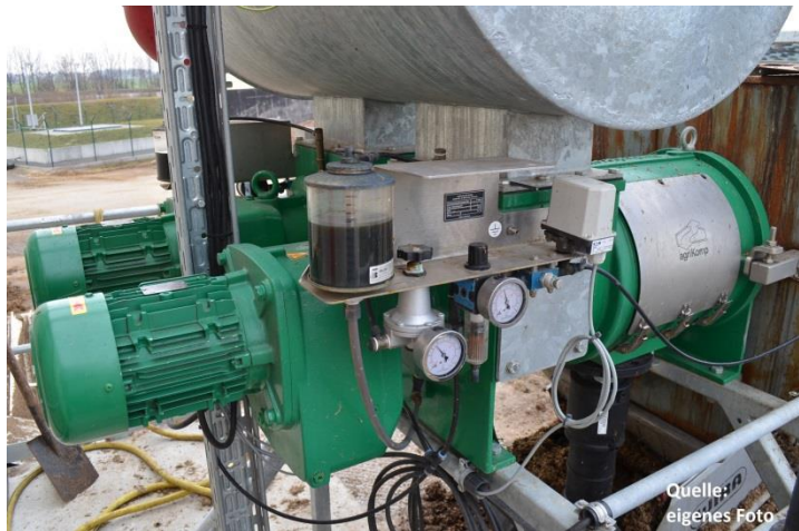
Bild 13: Pressschnecken mit Ölausgleichsbehälter, Druckluftanlage und Ausgleichsbehälter zur Substratzufuhr
