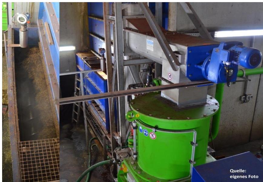
Bild 2: links: Fütterungsbunker mit Förderschnecke rechts: QZ mit Zuführschnecke
