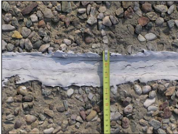
Ausgangszustand der Plattenfugen
