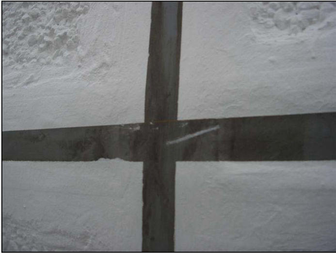
Anstrichvariante im Fugenkreuzbereich
