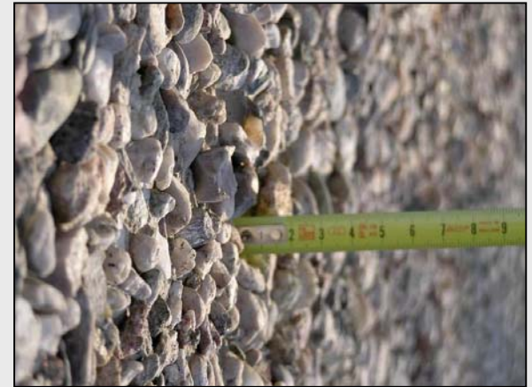
10-12 mm Höhendifferenz zwischen Beton und einzelnen Kieskörnern
