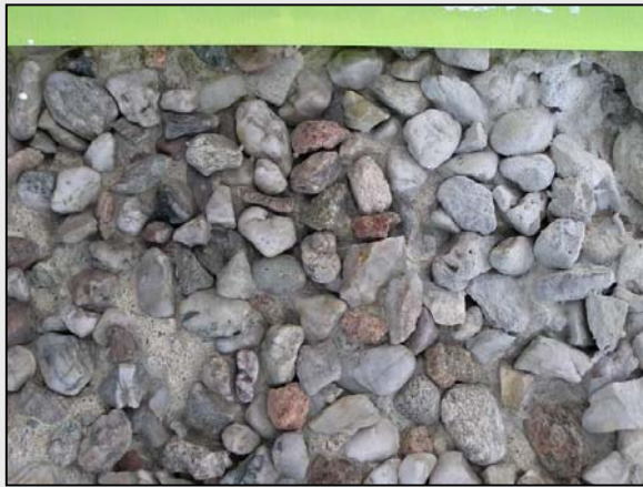
Grobkiesige Oberfläche der Wetterschalen- platte
