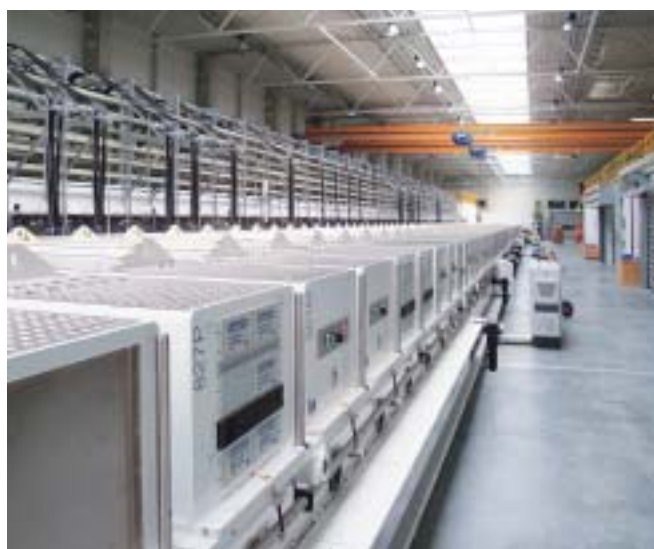
SILVERSTAR® Beschichtungsanlage Ujazd/Polen
