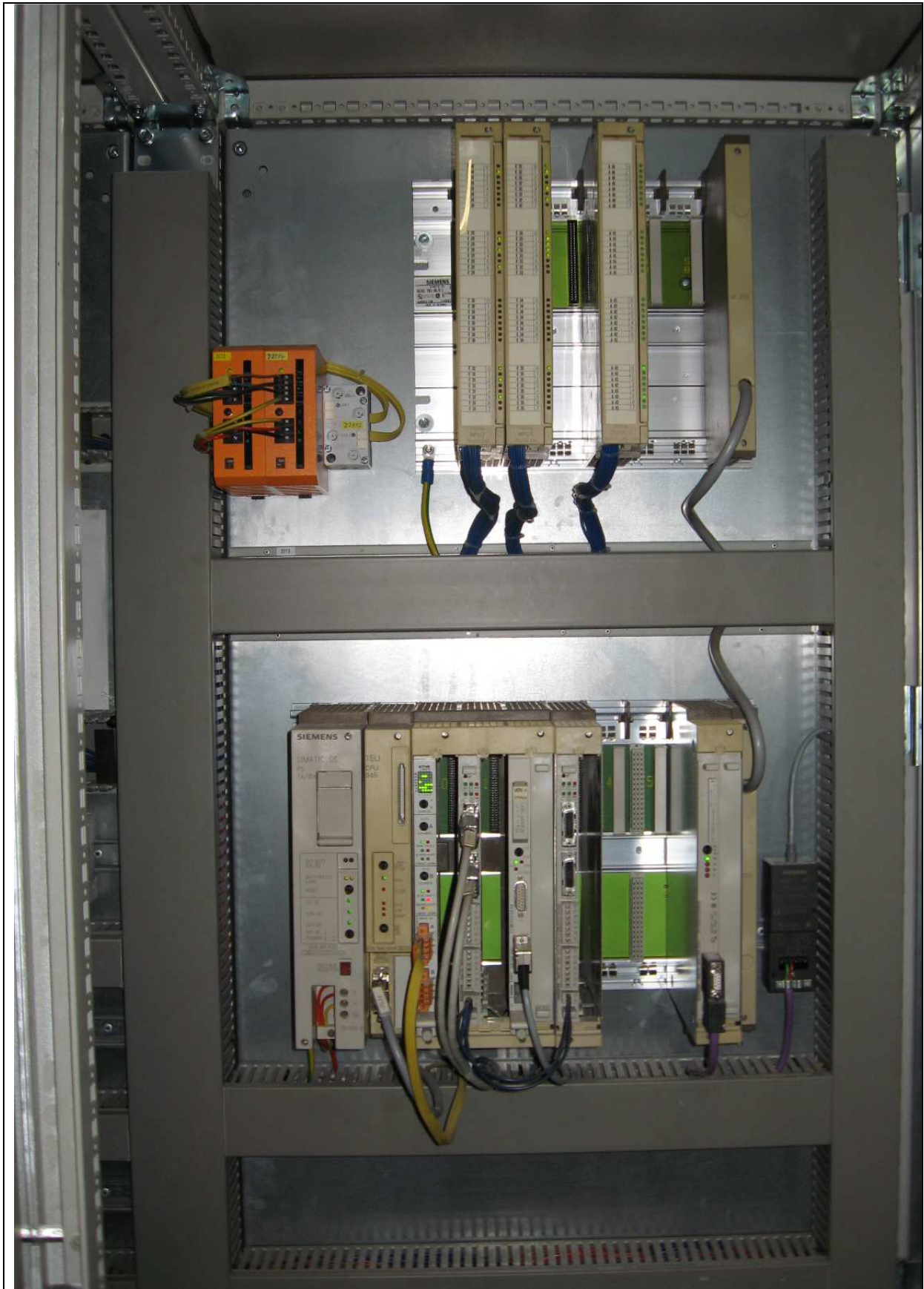
Abbildung 13: Schaltschrank Steuerung VSG1 (+081)
