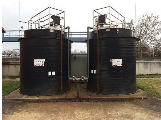
Abbildung 15 Fällmitteltanks der Kläranlage Silstedt [eigene Quelle: März 2017]
