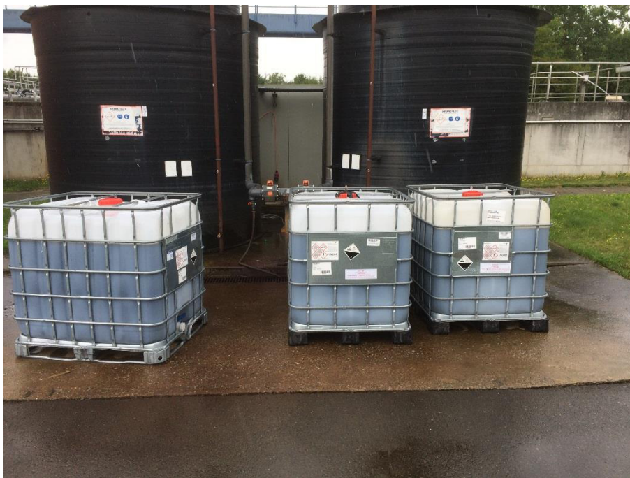
Abbildung 29 Aufgestellte IBC mit Eisen-III-Chloridsulfat [eigene Quelle: 2017]
