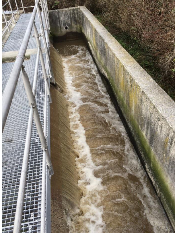
Abbildung 32 Ablauf des belüfteten Sandfanges KA Silstedt [eigene Quelle: 2017]
