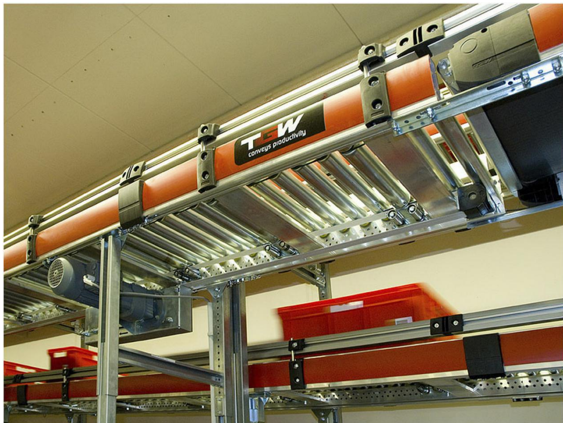
Abb. 32 Rollenbahnen und Verschiebewagen[17]
