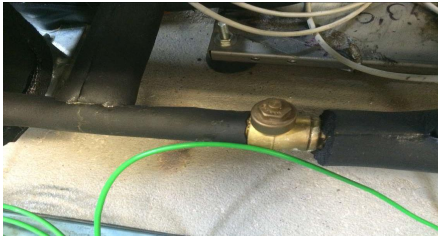
Abbildung 6.3: Absperrventil für Solevorwärmer
