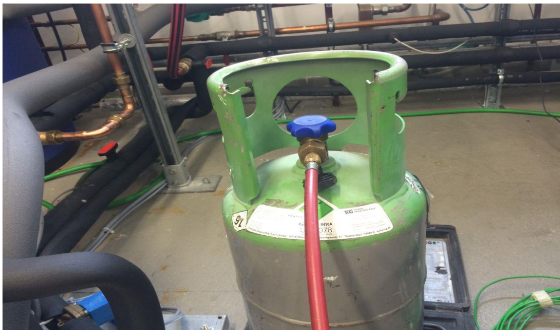
Abbildung 6.1: ein Tank von Kältemittel von R410a
