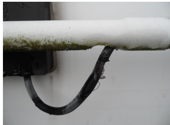
Abb. 12: Kabelschaden durch Aufscheuern Quelle: Eigene Darstellung
