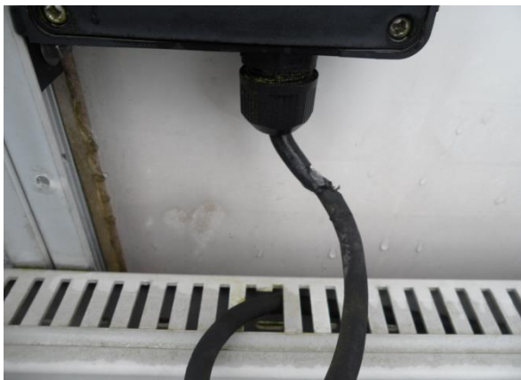
Abb. 11: Kabelschaden vermutlich durch Tierfraß entstanden Quelle: Eigene Darstellung
