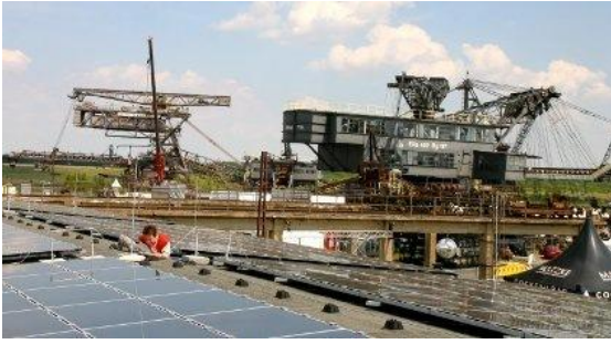
Abbildung 14: Solaranlage auf den Dächern der Lagergebäude
