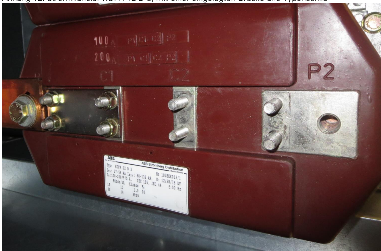
Anhang 12: Stromwandler KOFA 12 D 3; mit einer eingelegten Brücke und Typenschild
