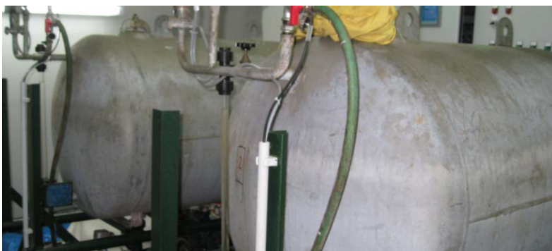
Abbildung 3.2: Darstellung Druckbehälter im Pumpenhaus
