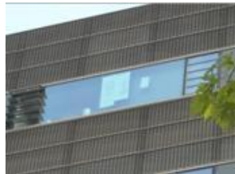
Abbildung 2 Papier als Ersatz für fehlenden außenliegenden Sonnenschutz
