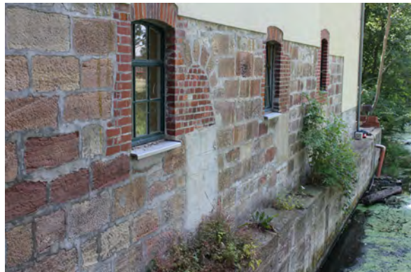
2019. Mühlenhof. Blick auf dem Turbinenraum. (HWZ #A.070)
