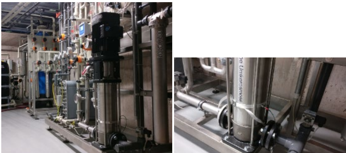
Abbildung 1: Ausschnitt der Aufbereitungsanlage mit Vorfilterstufe und applizierten Sensoren.
